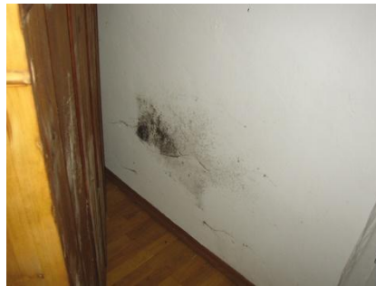
Punktförmige Wärmebrücke (Fehlstelle bei Vermauerung)
