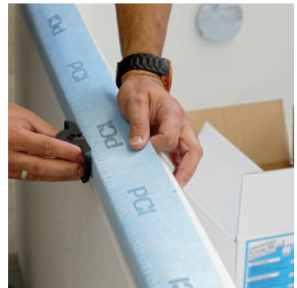
PCI Pecitape WDB mit dem Anpressroller kräftig anrollen, so dass keine Falten entstehen.
