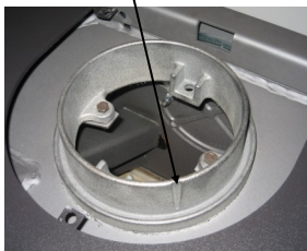
Markierung für den Kondensatablauf.
