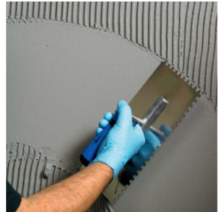
2. und evtl. 3. Auftrag im Spachtelverfahren mit einer geeigneten Glättkelle bis zur geforderten Gesamtschichtstärke aufbringen.
