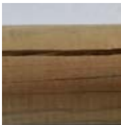
Cracks/Grietas/Fente/Risse/ Crepe/ Barsten/Fendas
