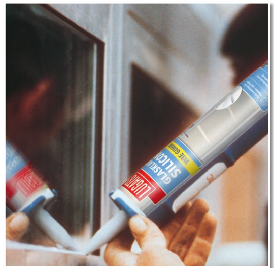
Fensterfalzversiegelung zwischen Glas und Aluminiumrahmen.
