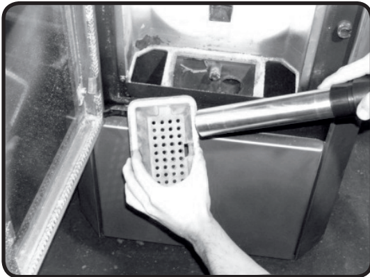
Abb. 14b: Reinigung der Luftöffnungen mit einem Staubsauger
